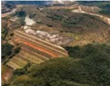
Barragem Sul Superior da mina Gongo Soco, em Barão de Cocais
